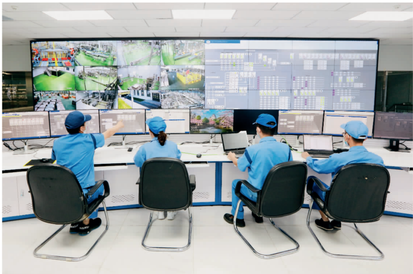
海河乳品公司智能化车间中控室
