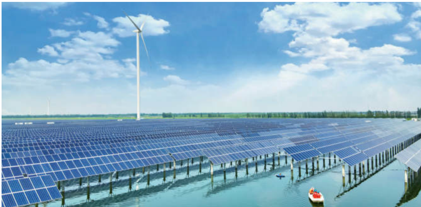
国网天津宁河公司员工到“渔光互补”光伏发电场上门服务 张茜 摄
